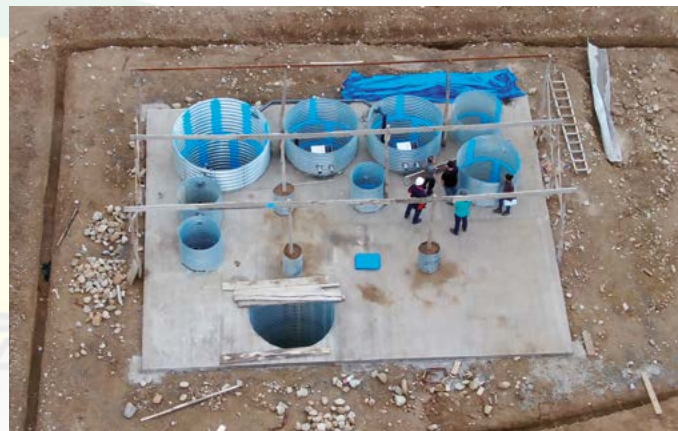
PTAR piloto en barrio catedral.
