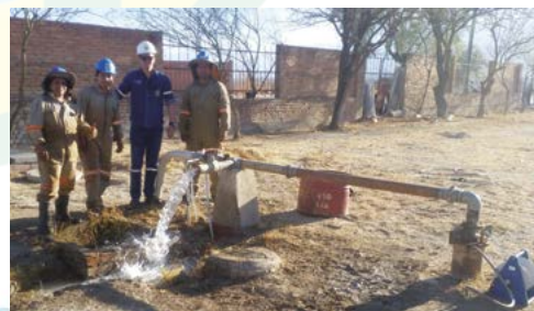
Conclusión de Mantenimiento de Electrobomba Pozo P. A. Flores
